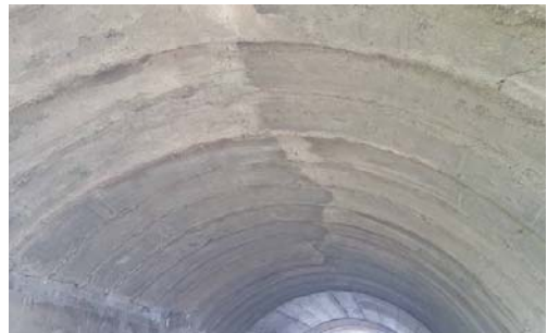
图 6 腹拱圈拱顶横桥向贯穿纵缝
