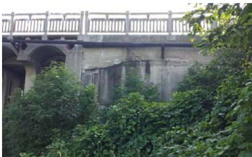
图 7 侧墙水平开裂
