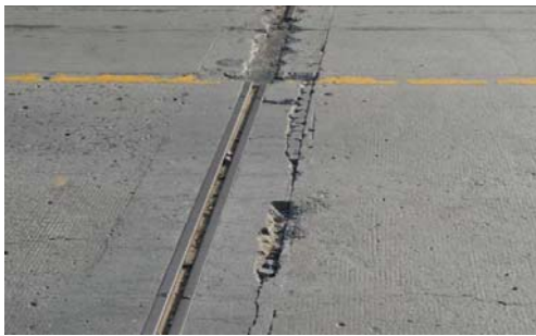
图 3 伸缩缝钢梁断裂、锚固区砼破损
