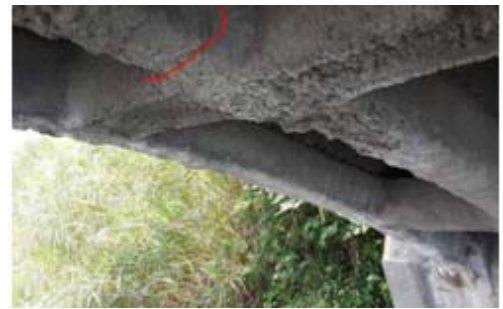
图 4 拱肋多处径向裂缝伴渗水钙化
