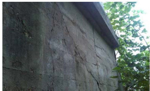
图 8 侧墙斜向开裂
