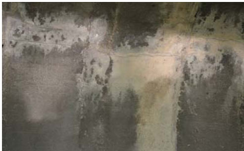
图 5 拱波顶部纵缝伴渗水钙化
